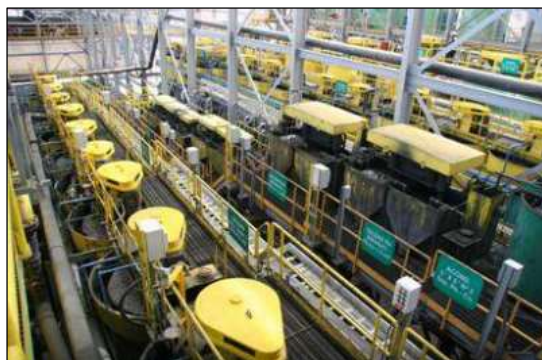
Figura 5: Tanques de flotación de la planta de beneficio de Cerro Lindo
